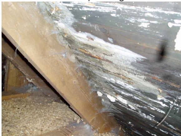
Inläckage eller ventilationsproblem?
