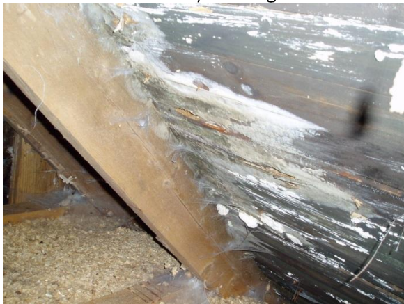
Inläckage eller ventilationsproblem?
