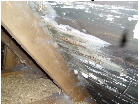
Inläckage eller ventilationsproblem?
