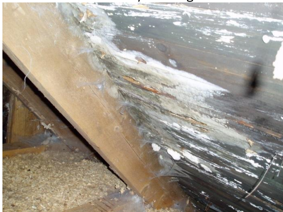
Inläckage eller ventilationsproblem?
