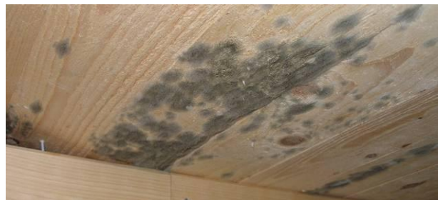
Bild 1: Mikrobiell påväxt på råspont ( http://www.sporium.se )
