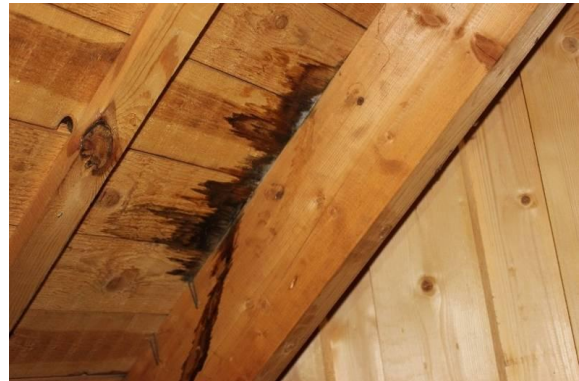
Bild 2: Rinningar från läckage (Conservator)
